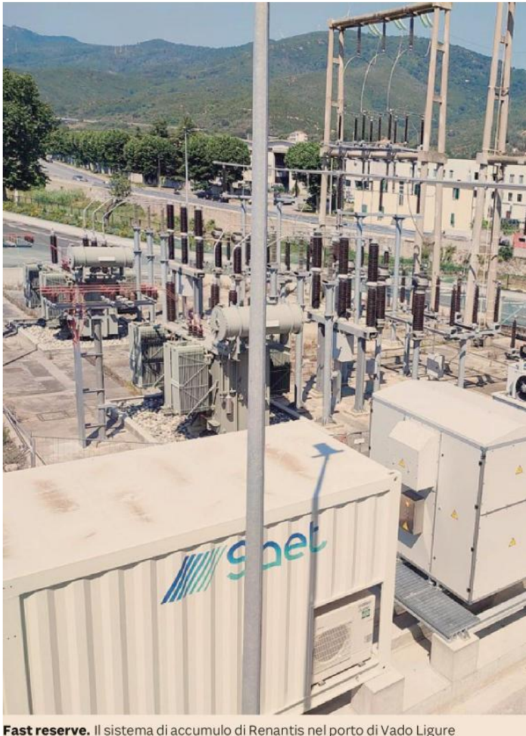
Fast reserve. Il sistema di accumulo di Renantis nel porto di Vado Ligure
