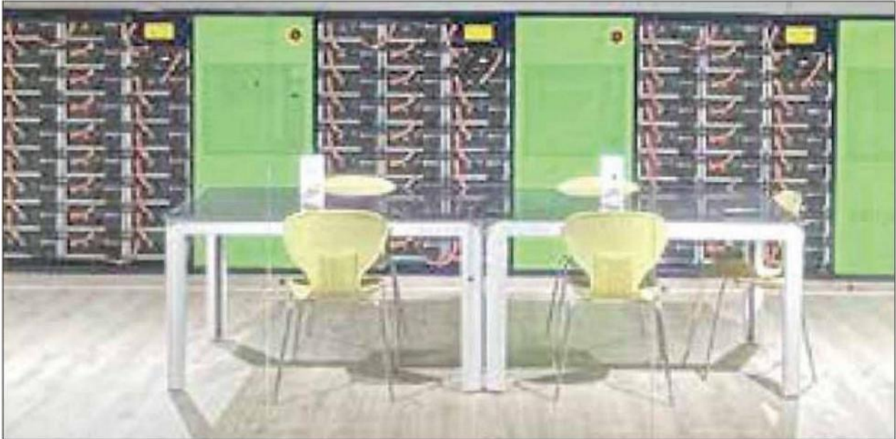
Dietro al tavolo uno dei sistemi di stoccaggio dell'energia realizzati da Energy Spa
